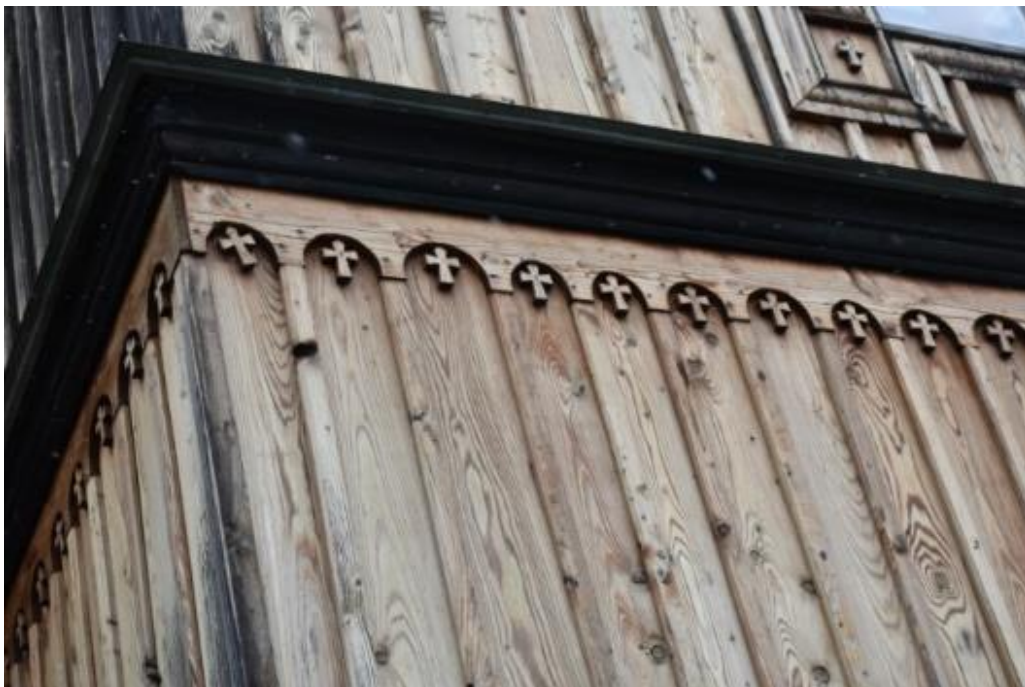
Fot. 11. Krzeszów, Kościół Narodzenie NMP. Widok od strony południowej. Fragment. Widok na gzyms kordonowy- prawdopodobnie pierwotny drewniany element. Stan przed konserwacją. Fot. I. Widlińska, 2022.
