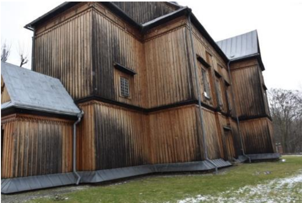
Fot. 4. Krzeszów, Kościół Narodzenie NMP. Widok od strony północno-zachodniej. Zauważalne czarny nalot. Stan przed konserwacją. Fot. I. Widlińska, 2022.
