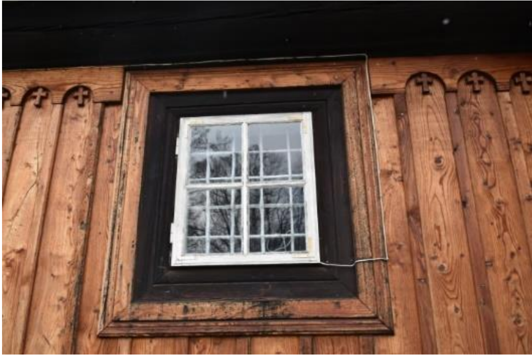
Fot. 8. Krzeszów, Kościół Narodzenie NMP. Widok od strony południowej. Fragment elewacji. Widok na okienko. Obramienie to prawdopodobny pierwotny drewniany element kościoła. Stan przed konserwacją. Fot. I. Widlińska, 2022.
