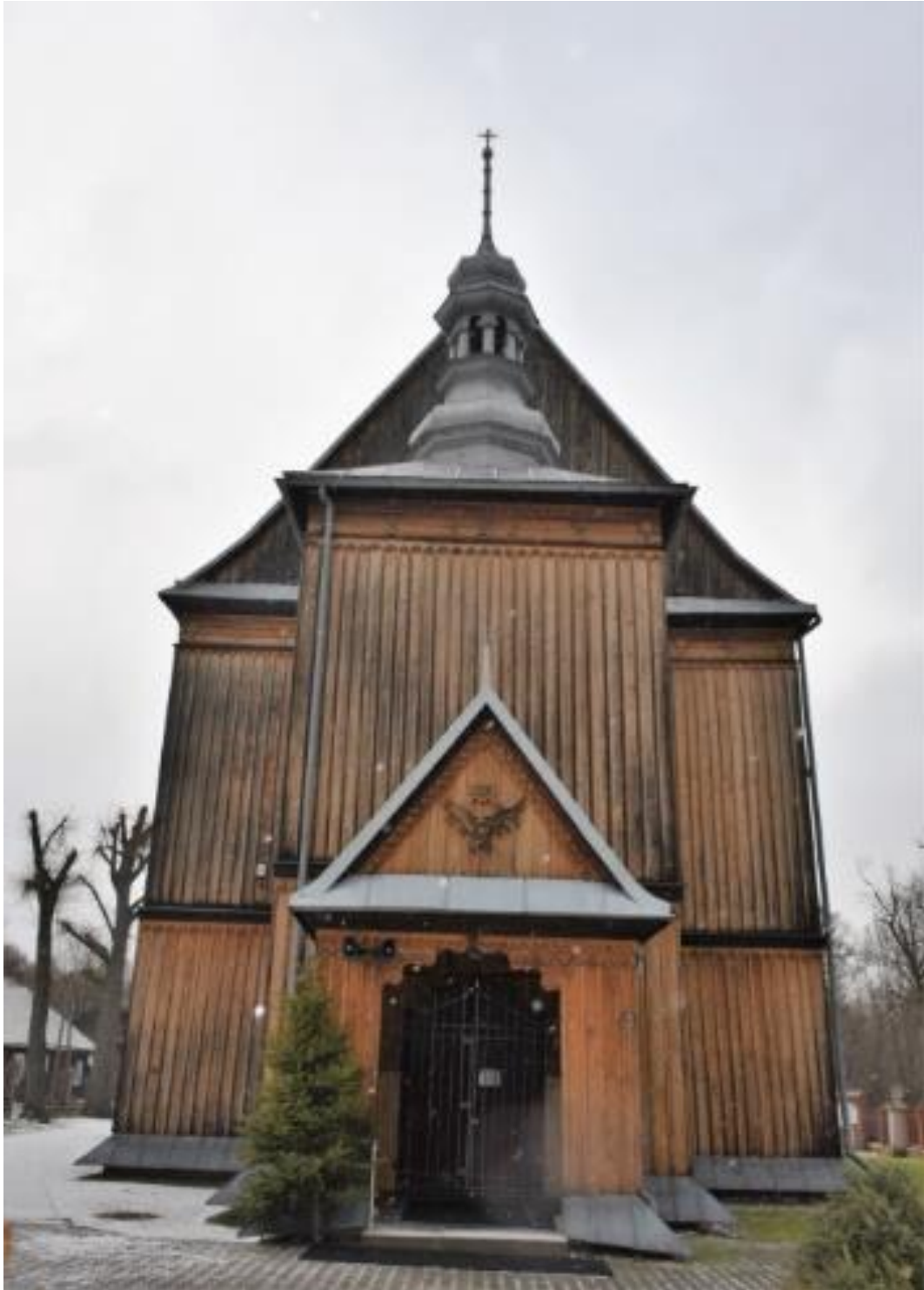
Fot. 5. Krzeszów, Kościół Narodzenie NMP. Widok od strony zachodniej. Stan przed konserwacją. Widoczny czarny nalot na deskach oszalowania. Fot. I. Widlińska, 2022.
