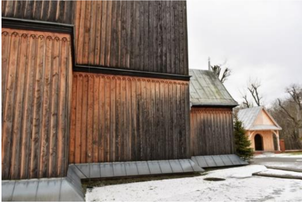
Fot. 12. Krzeszów, Kościół Narodzenie NMP. Widok od strony północnej. Fragment elewacji. Widoczne zaczerwione obszary elewacji. Stan przed konserwacją. Fot. I. Widlińska, 2022.
