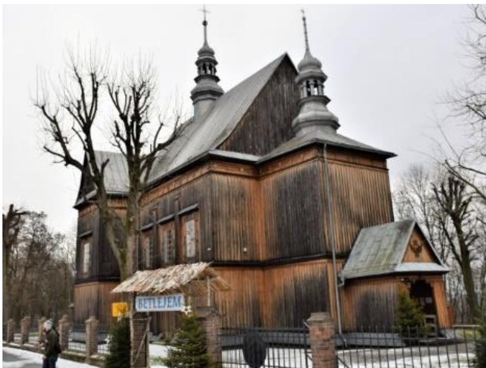
Fot.1. Krzeszów, Kościół Narodzenie NMP. Widok ogólny. Widok od strony północno-zachodniej. Widoczne zaczerwione obszary na elewacjach obiektu. Stan przed konserwacją. Fot. I. Widlińska, 2022.
