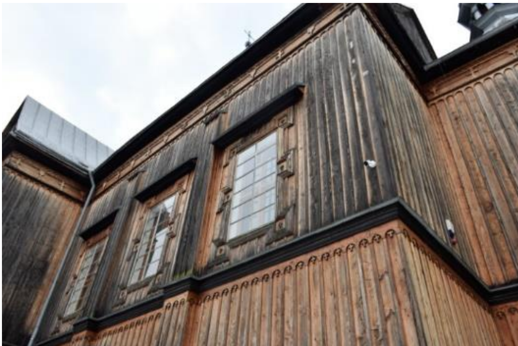
Fot. 9. Krzeszów, Kościół Narodzenie NMP. Widok od strony północnej. Fragment elewacji z oknami. Zauważalny czarny nalot. Stan przed konserwacją. Fot. I. Widlińska, 2022.
