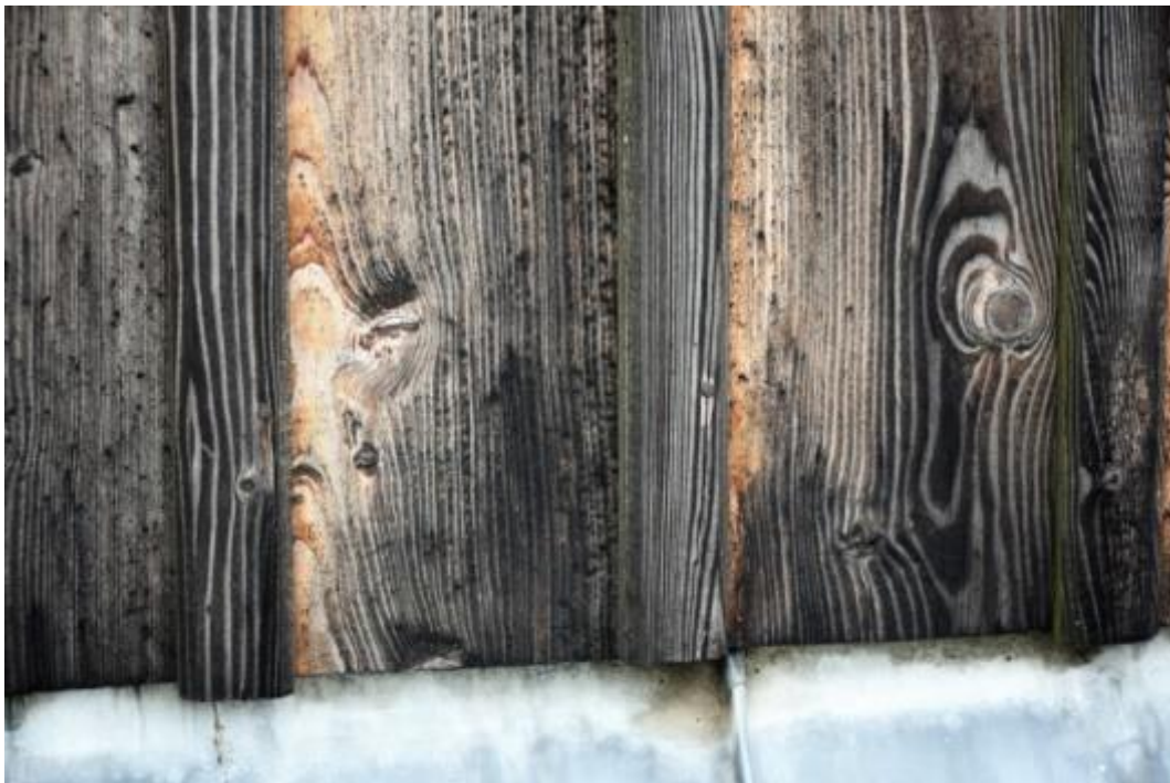
Fot. 13. Krzeszów, Kościół Narodzenie NMP. Widok od strony wschodniej. Fragment. Widok na czarny nalot na powierzchni desek. Stan przed konserwacją. Fot. I. Widlińska, 2022.
